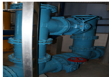
Lyre incendie du réservoir du Tannenwald - SDEA©
