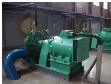
Pompe de refoulement vers le réservoir d'Oberhausbergen
